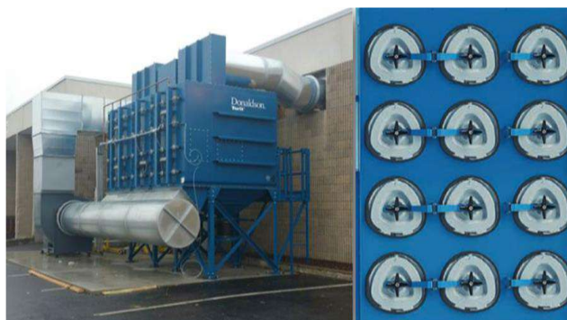
Figure 66 : Exemple d'implantation d'un dépoussiéreur DFE & détail des portes
